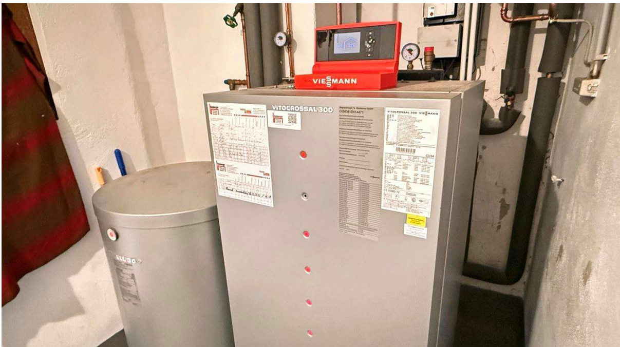
moderne Brennwert-Erdgasheizung, Baujahr 2012
