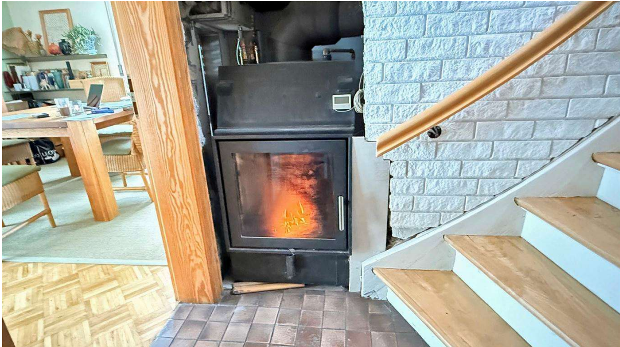
wasserführender Kaminofen als 2. Zentralheizung
